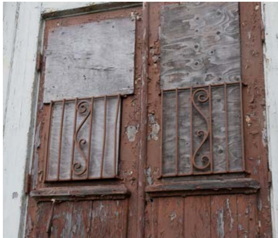
3. Underhållsbehovet är stort men fortsatt är byggnadens ursprungliga arkitektoniska kvaliteter och detaljrikedom synlig. Pardörrarna med smidd dekor går till den gamla biografen.
