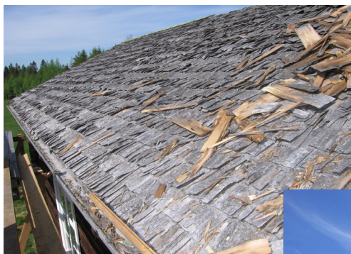
Bild 1. Spåntaket före åtgärd.
