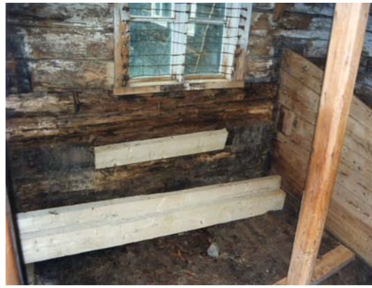
Bild 16. Skador i ett av kobåsen före åtgärd.
