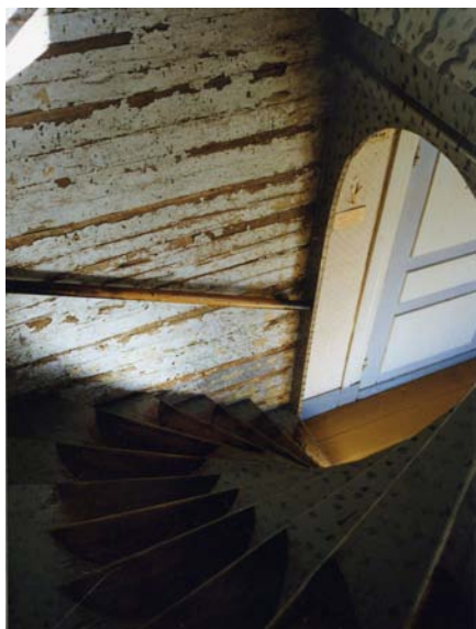
Bild 5. Enkelstugans trapp före åtgärd.
