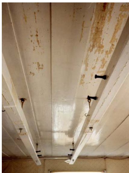
Bild 9. Kökstaket i enkelstugan före åtgärd.
