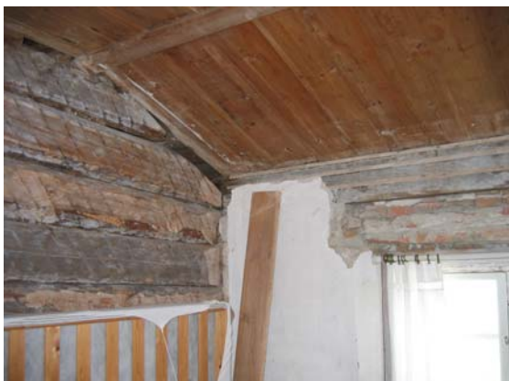
Mellanväggen har tidigare varit reveterad, denna revs ned av ett misstag. Spår efter de diagonalställda ribborna är synliga på timmerväggen.
