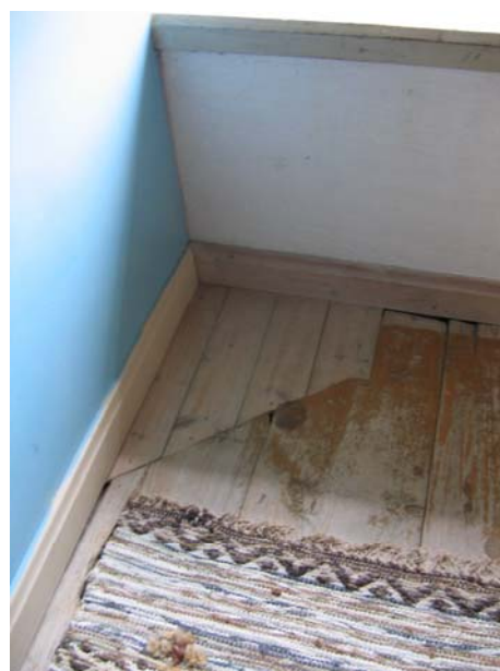
Nya brädor har lagats i sen man ändrade trappans riktning i samband med att trapphuset byggdes.
