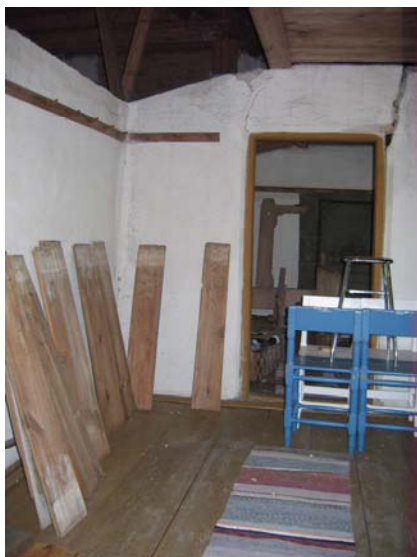
Kammaren sedd mot den yttre drängkammaren. Takbrädorna mot storvinden är nedplockade.
