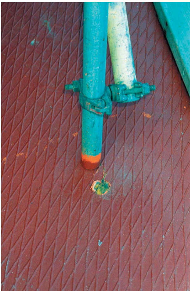
Bild 28. Närbild av skada efter ställning på plattformen.
