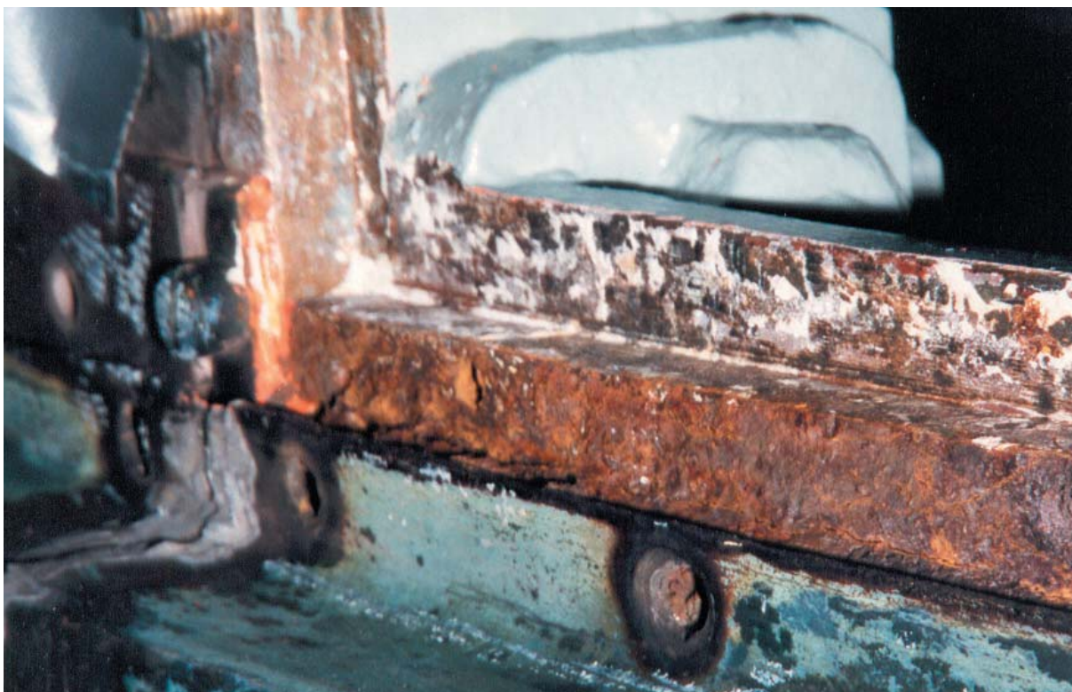
Bild 10. Närbild av lanterninens fönsterkarm före åtgärd.
