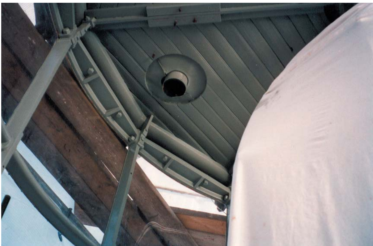
Bild 46. Närbild av kondensvattenröret efter ommålning.
