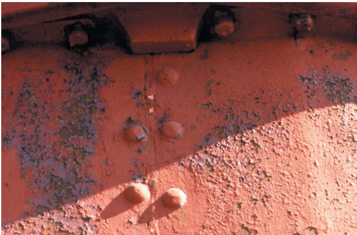
Bild 12. Närbild av rost på fyrhuset.
