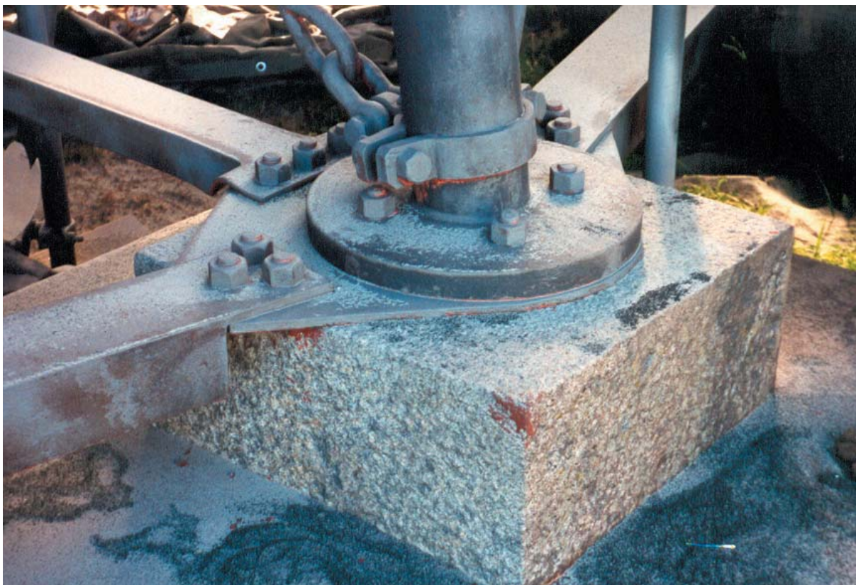
Bild 3. Närbild av fyrens fästningsanordning efter blästring.
