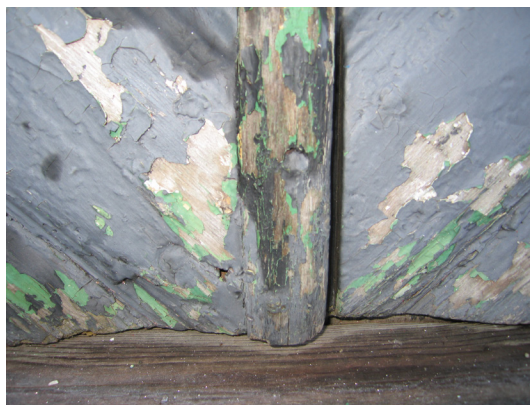
Bild 10. Närbild av färglager på pardörren.
