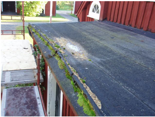
Bild 3. Yttertakets kant på förstugan före åtgärd.
