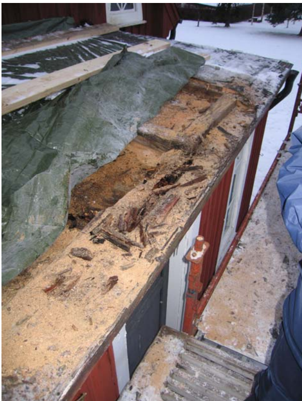
Bild 2. Taket efter borttagning av pappen samt delar av rotet.
