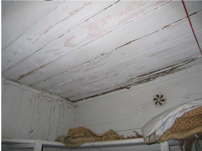
Bild 3. Fuktskador i innertaket, utrymmet till vänster.
