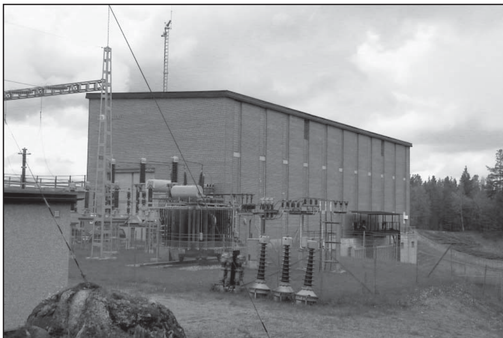
Betsela kraftstation. Foto Lage Johansson.
