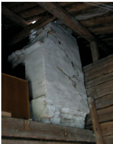
Bild 3. Spricka i murstock på vind.
