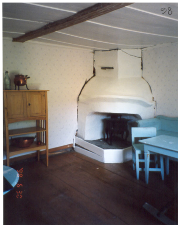
Bild 2. Kammare 98 före åtgärd.
