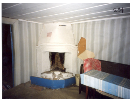
Bild 4. Kammare 234 före åtgärd.
