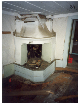
Bild 3. Kammare 241 före åtgärd.
