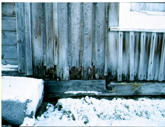
Bild 3. Rötskador i nederkant av fasad.
