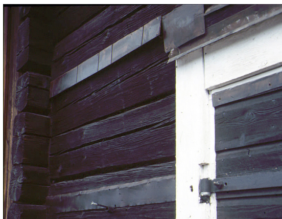
Bild 4. Plåtbeklädnad på vägg som skydd mot röta.
